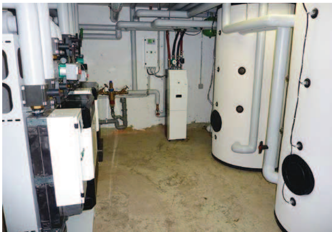
In der Heizzentrale eines jeden Gebäudes heben Wärmepumpen bei Bedarf die Temperatur des solar vorgewärmten Brauchwassers auf das gewünschte Niveau an.
